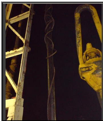
Gambar 4. Sand Line yang terlilit pada tubing
