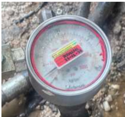
Gambar 6. Pembacaan tekanan 250 psi menggunakan pressure gauge pada pengujian tekanan rendah annular preventer 13 5/8 inci
